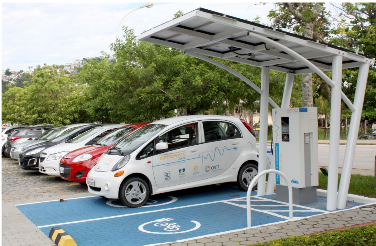
Figura 17: Estação de carregamento de veículo elétrico da Celesc.
