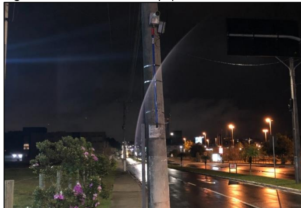
Figura 10: CPM-P002 – Equipamento Instalado.
