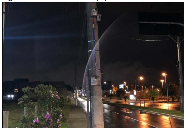
Figura 19: CPM-P002 – Equipamento Instalado.
